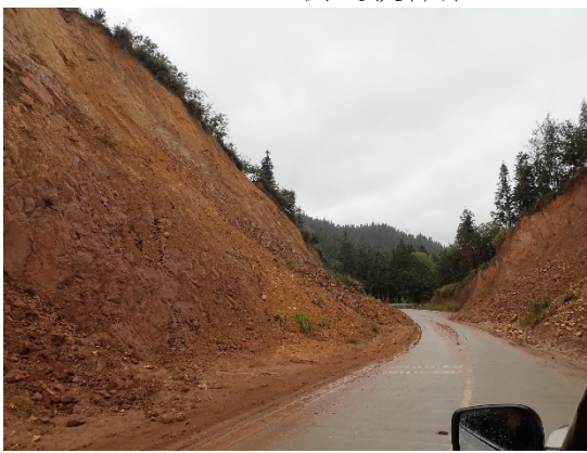
K16+950 左侧边坡裸露
