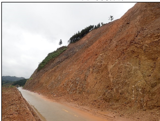
K51+450 右侧边坡裸露
