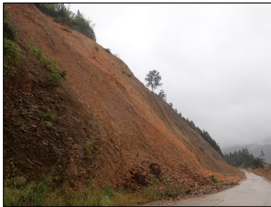
K32+200 左侧边坡裸露
