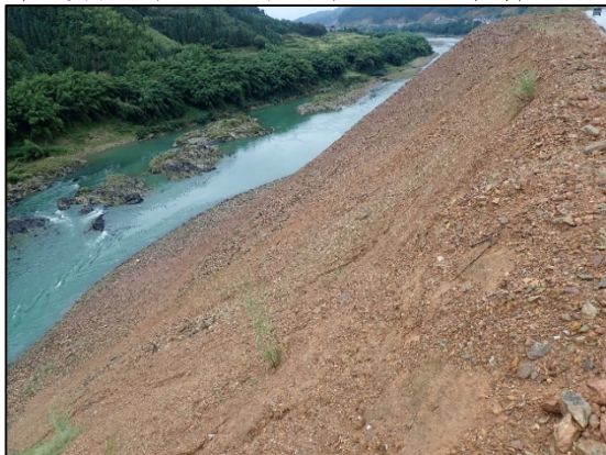
K51+450 左侧边坡裸露
